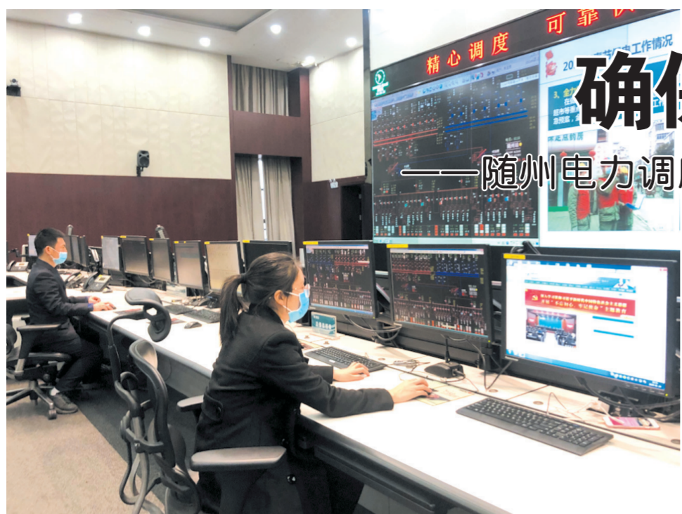
图为国网随州供电公司调控中心调度人员,全神贯注、精心调度,确保疫情期间城乡安全用电。(随州日报通讯员 黎 姣摄)
