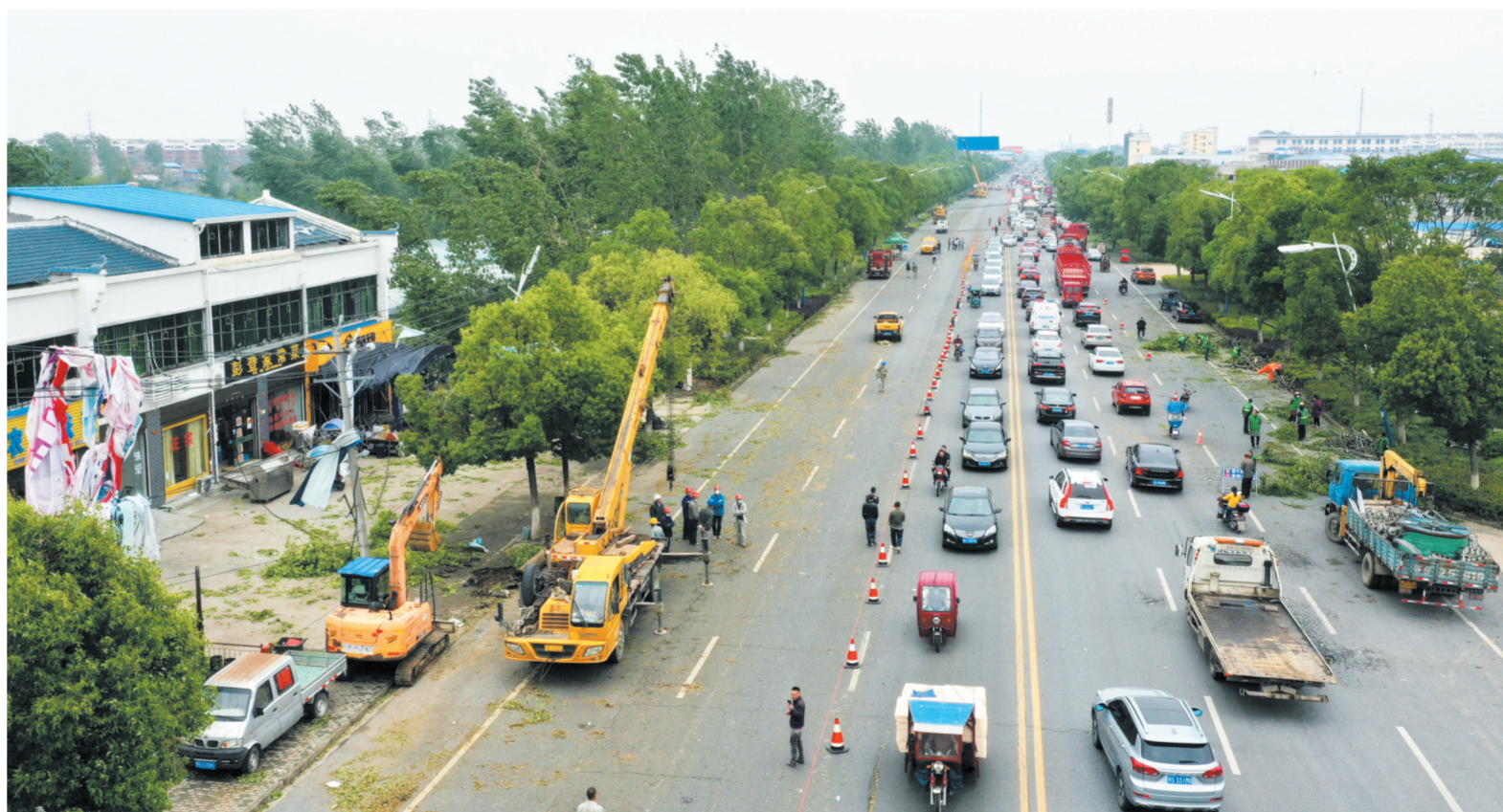
5月4日晚,我市局部地区遭受冰雹、雷电、大风强对流天气,部分房屋、树木、电线受损。图为5月5日上午,供电、城管等部门在曾都经济开发区两水沟社区抢修线路,清理路障。
