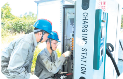
▲ 供电公司员工正在维护充电桩
