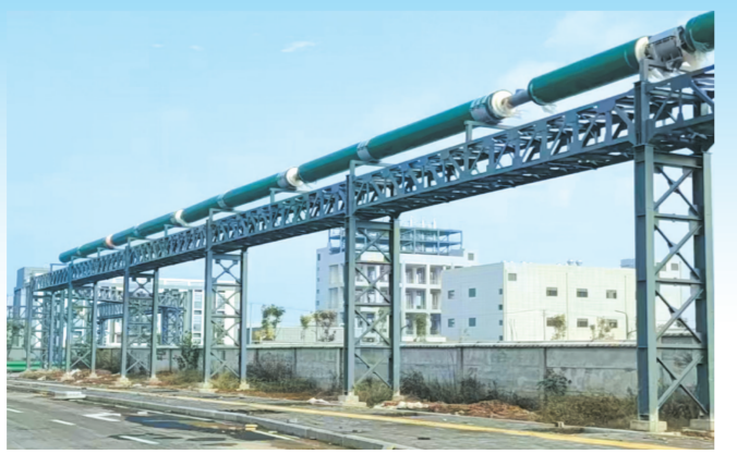
▲ 总投资5.5亿元的园区集中供热项目
