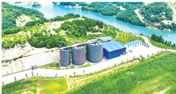
污水处理系统
